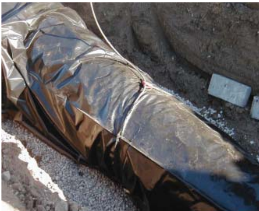
Damaged PE wrapping.
